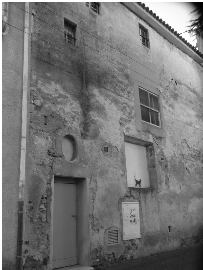
Façade de l'ancienne fabrique de molletons Rue du colonel Vialla (Photographie G. Guiraudet)
